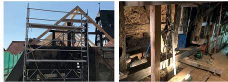
Der Dachstuhl musste erneuert werden
